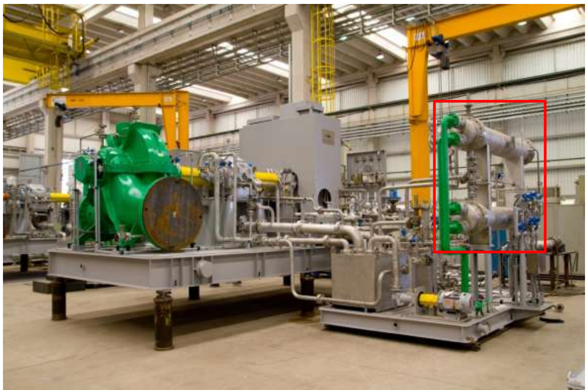
Figura 5 – Vaso de pressão de sistema de lubrificação de turbinas a vapor, em skid separado da turbina
