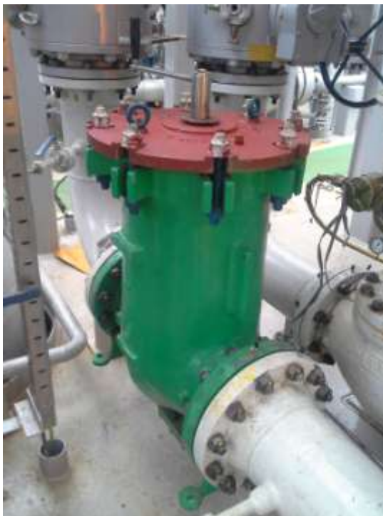
Figura 14 – Filtro suportado pela tubulação
